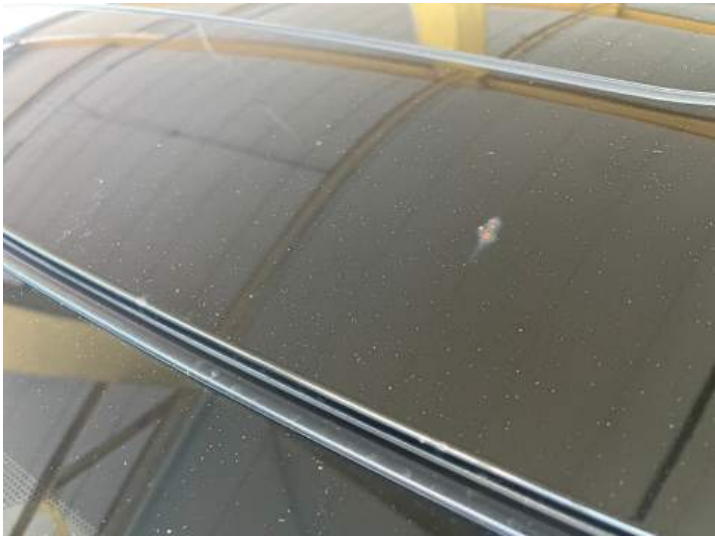
Dach (Rost, Lackschaden)
