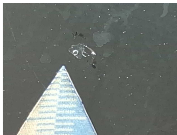
Beschädigung #1: Verglasung: Frontscheibe - gebrochen / gerissen - erneuern
