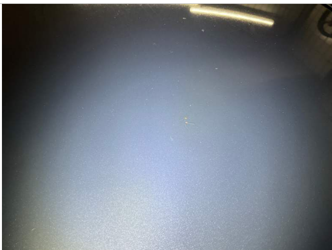
Dach kleine Steinschläge mit Korrosion
