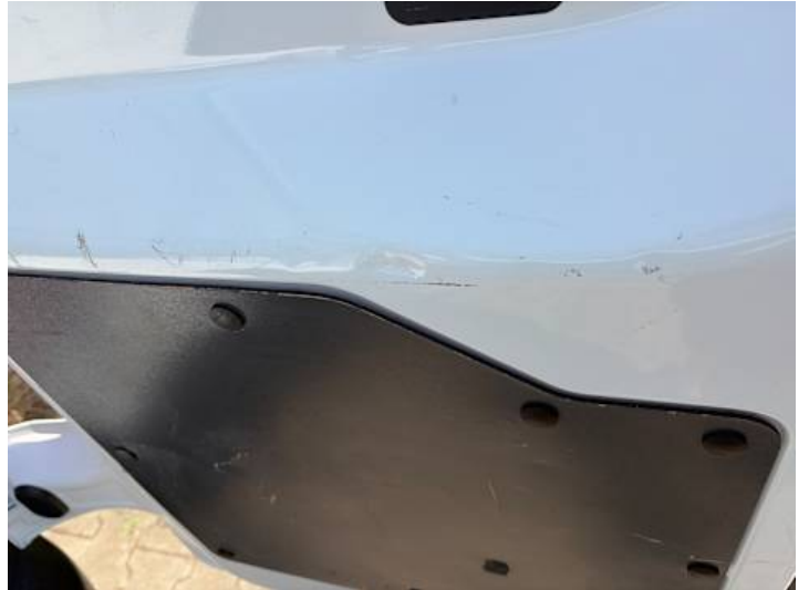
Innenraum (Anderer Schaden): Dellen
