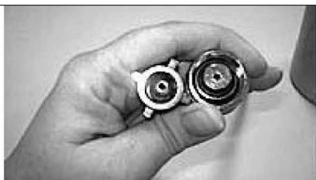
O-Ringe an der CO2-Leitung
