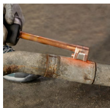
Dégrillage de ligne d'échappement
