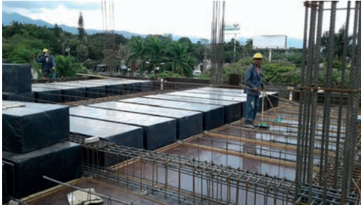
Foto 2: casetones de icopor envueltos en plástico e instalados sobre el encofrado antes de verter la mezcla de concreto o fundir la losa.
