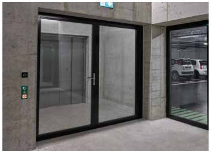
SafeRoute-System und Leser für Garagenzugänge
