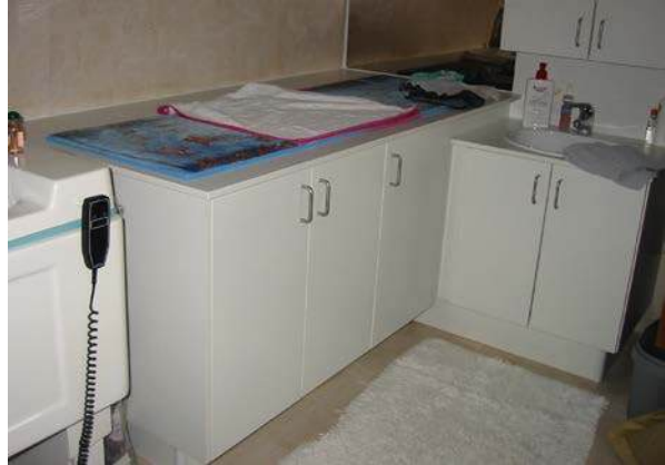
Wastafel geplaatst naast vaste verzorgingstafel © Toegankelijkheidsbureau vzw
