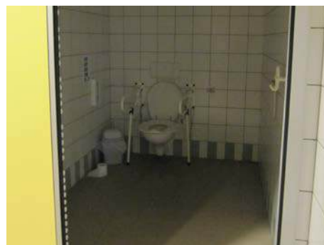
Aangepast toilet met 1 transferzijde.
