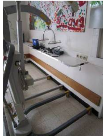
Laadpunt met meerdere stopcontacten per plaats.
