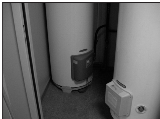
Figuur 1 Elektroboiler rustoord
