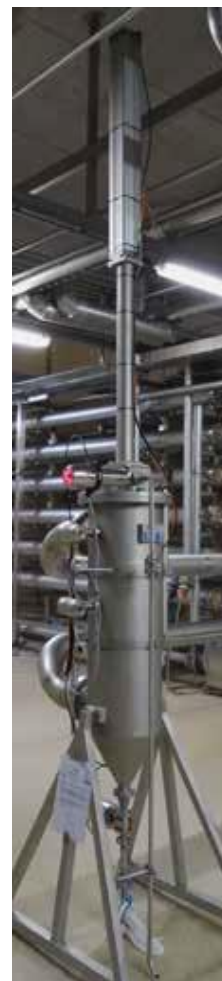
Auto-line XXLE sikkerhetsfilter for kondensatfiltrering før UF/RO-installasjon
