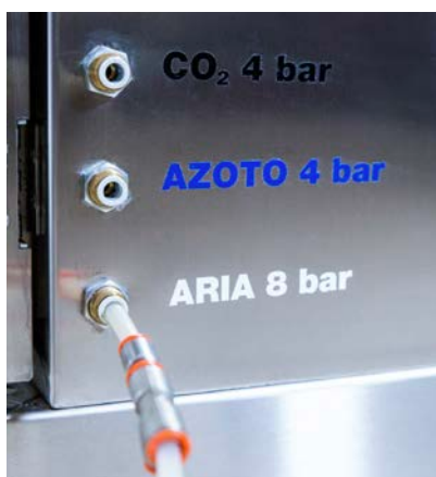
CONEXIONES DE GAS DE PROCESO: AIRE COMPRIMIDO, NITRÓGENO Y CO 2
