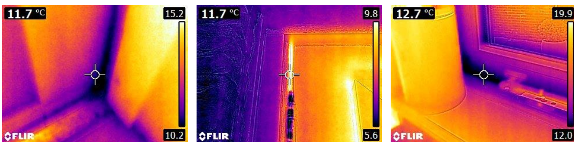
Van links naar rechts: sluitzijde achterdeur keuken, hang/draaizijde achterdeur keuken en keukenraam.
