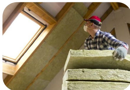
Schuin dakisolatie binnenzijde
