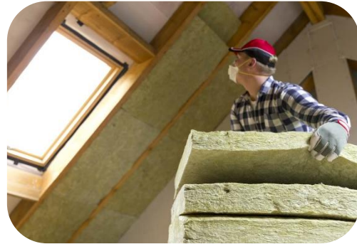
Schuin dakisolatie binnenzijde
