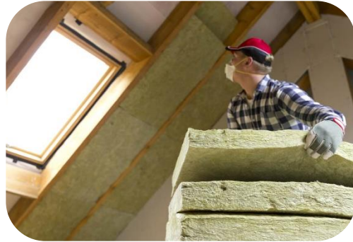
Schuin dakisolatie binnenzijde
