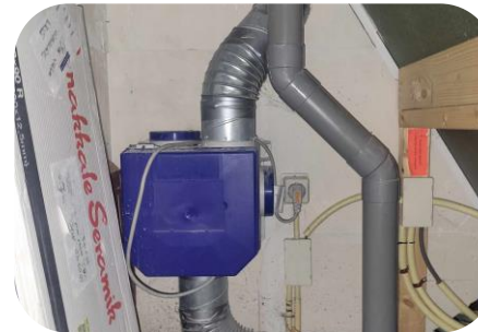
Mech. Ventilatie met sturing
