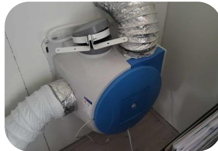
Mech. Ventilatie met sturing
