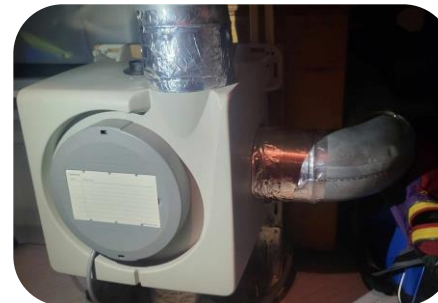
Mech. Ventilatie Wisselstroom
