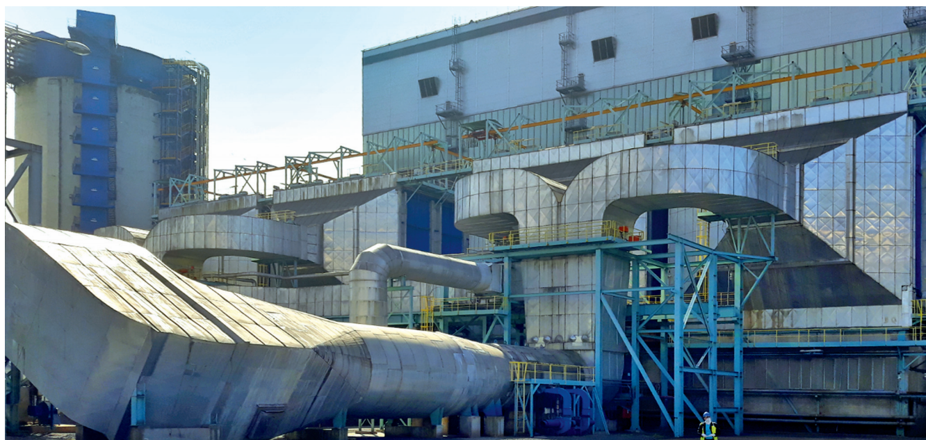
Pohled na technologii.
