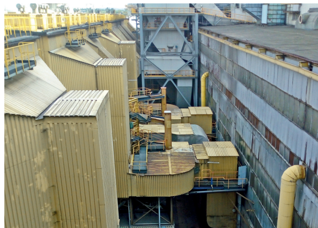
Záběr na stávající elektrostatické odlučovače.
