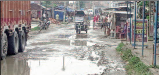
सड़क जर्जर टापू में तब्दील।
