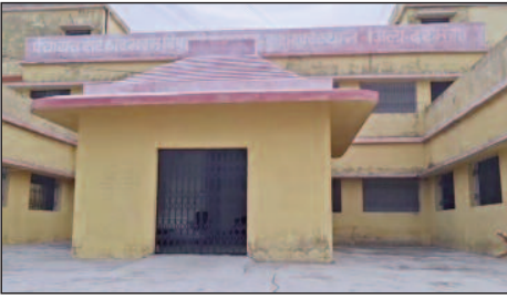
बिशहरिया मोहिम बुजुर्ग पंचायत में जर्जर हालत में पंचायत सरकार भवन
