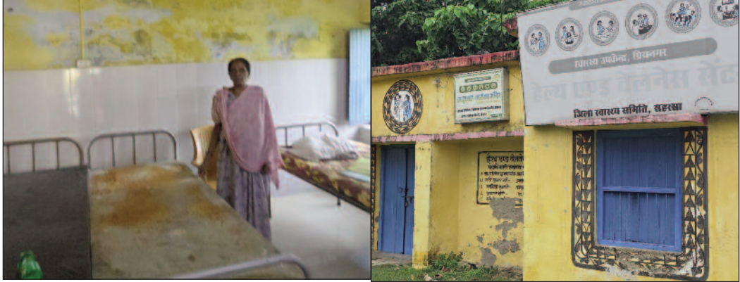
जर्जर भवन, बारिश में टपकती छत
