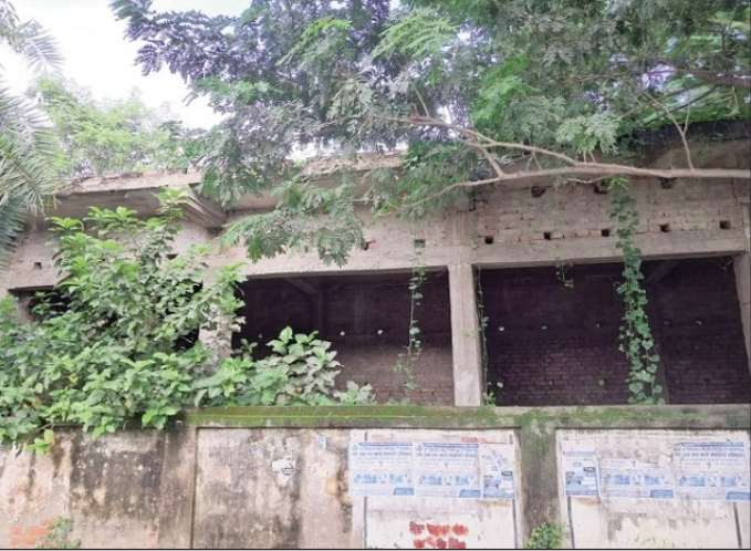
कांटी प्रखंड मुख्यालय परिसर स्थित जर्जर व जंगलो से ढका अर्द्धनिर्मित व्यवसायिक भवन।
