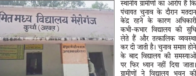
जर्जर विद्यालय भवन।
