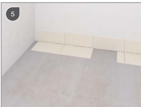
Tegellijm (EN12004C2) uitstrooien/Spread of the tile adhesive (EN 12004 C2)/Appliquer de la colle à carrelage (EN 12004 C2)/ Flexkleber EN 12004 C2 aufziehen
