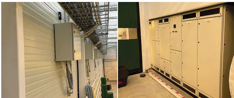
Sensorene er montert i både små og store koblingsskap, totalt 48 skap.
