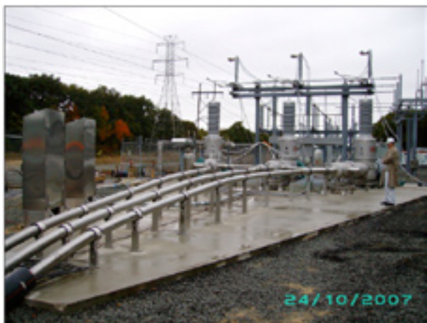
Figure 3 : câble supraconducteur (BiSrCaCuO à 70 K) LIPA (138 kV, 600 MVA) (photo Nexans).
