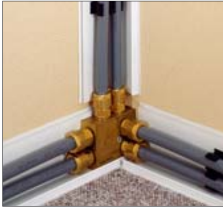
41. Colombusæg monteret i hjørne ved gulv.
