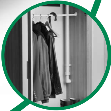
Rørføring i skab
