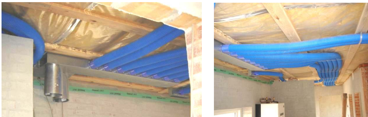
Figur 15: Fordelerbokse gulv placeret i loft.
