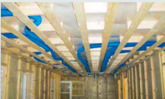
Loftsinstallation, der viser slangernes fleksibilitet.
