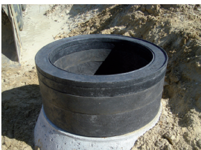
Ø600 topringe på beton kegle.
