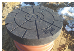
Beskyttelsesdæksel under byggeri.
