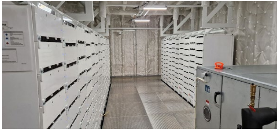
Batterierommet, eller det "heilage rommet". Her ser vi alle batteripakkane til MF Suløy.
