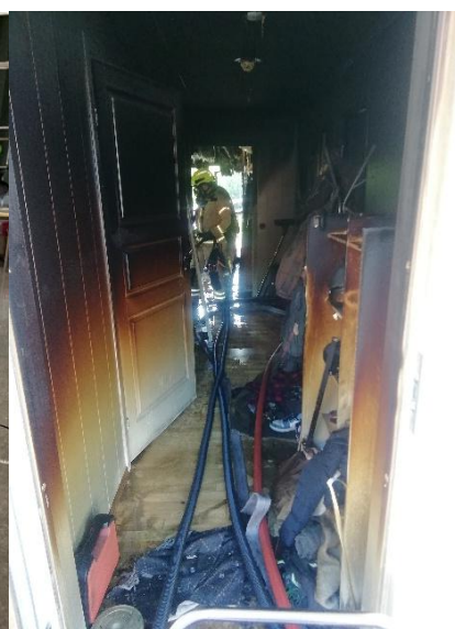
Bygningsbrann i Flekkefjord
