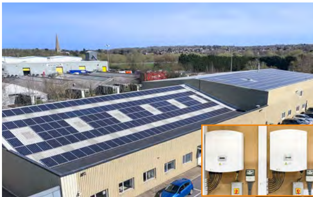
Grundfos Rooftop, UK 123.4kW
