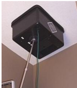
Mn Exhaust Fan Flow Meter
