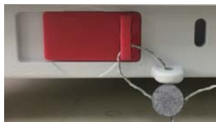
Bloqueado con cable de sellado
