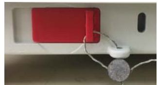
Bloccato con Sigillo di Cavo
