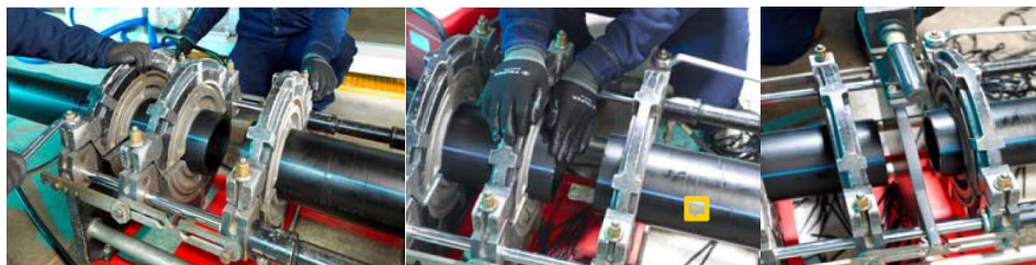
Posicionar los elementos a soldar en la máquina, fresar las partes a soldar y verificar la alineación
