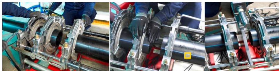
Posicionar los elementos a soldar en la máquina, fresar las partes a soldar y verificar la alineación
