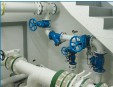
Rohrkeller mit Druckreduzierventilen, Aesch
