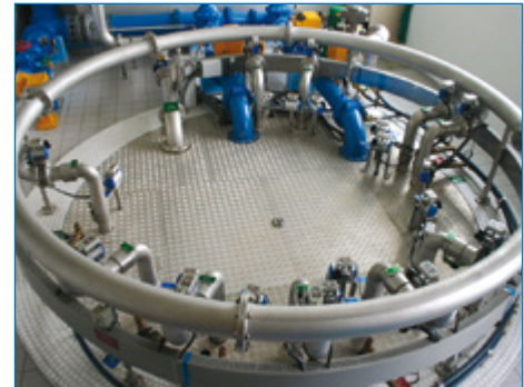
Brunnen, Grundwasserpumpwerk Bächau II
