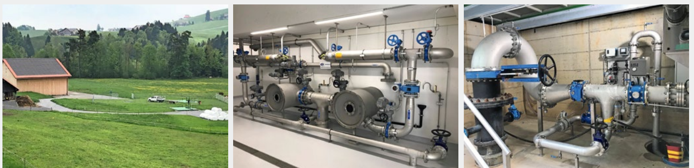
Fig. 2 Aufbereitungsanlage Geissboden (v. l.): Gebäude mit Solaranlage und der Brunneneinstieg; Verrohrung in der Aufbereitungsanlage und Verrohrung vom Grundwasserbrunnen.
