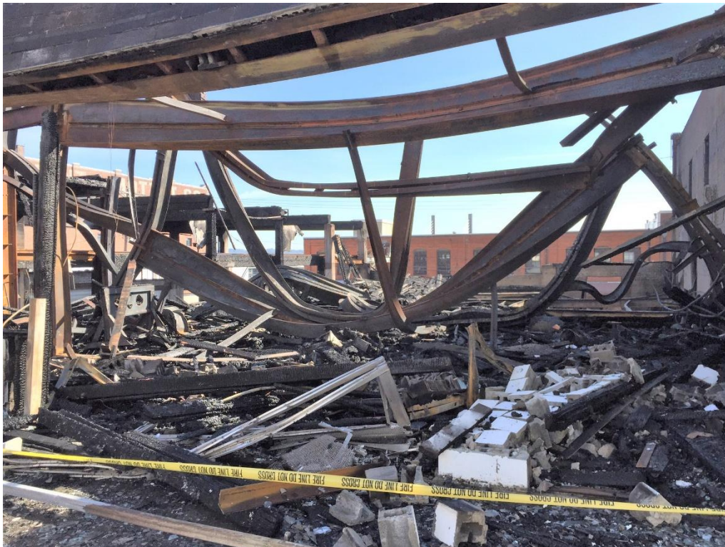
Figur 1 Deformert stål etter brann i en fabrikk
