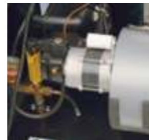
En-faset motor koblet til vifte og dieselpumpe.
