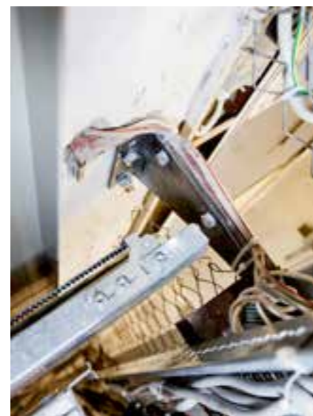
▶ Klaringen mellom den automatiske heisdøren (det lysegrå metallet) og bærekonstruksjonen (det mørkegrå metallet) er minimal når døren åpnes.
