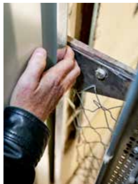
▶ For å få plass til automatiske dører i den store heisen måtte de brede kanaljernene kappes av og erstattes med en smalere brakett nærmest døren. Eriksen får så vidt plass til fingrene mellom heisdøren og braketten når dørene er åpne.
