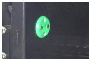
Vochtsensoren geplaatst in de balenkamer.
