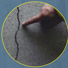
Rachaduras e Fissuras
