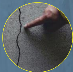
Rachaduras e Fissuras
