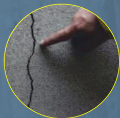
Rachaduras e Fissuras
