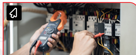
Équipements de test et de mesure
