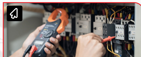
Équipements de test et de mesure
