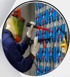
Bancos de baterías
