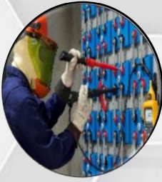
Bancos de baterías
