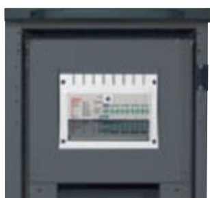
0 406 50 sans 0 406 52 dans une baie LCS 2
